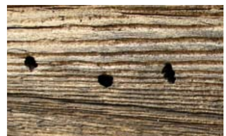
Foto 4. Vanade väljalennuavadega ei ole vaja midagi ette võtta.
