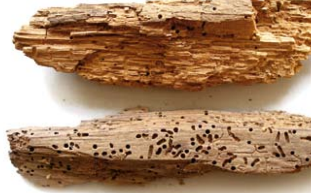
Foto 1. Puit, mida tooneseplastel on tugevasti kahjustanud. Vanal kahjustuskohal on näha küllaltki väikesed väljalennuavad.
